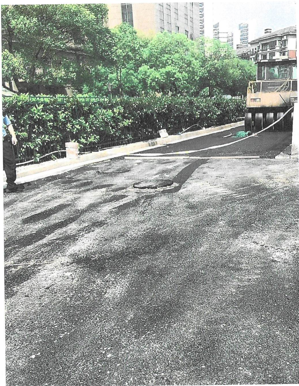
(施工事故现场照片)
