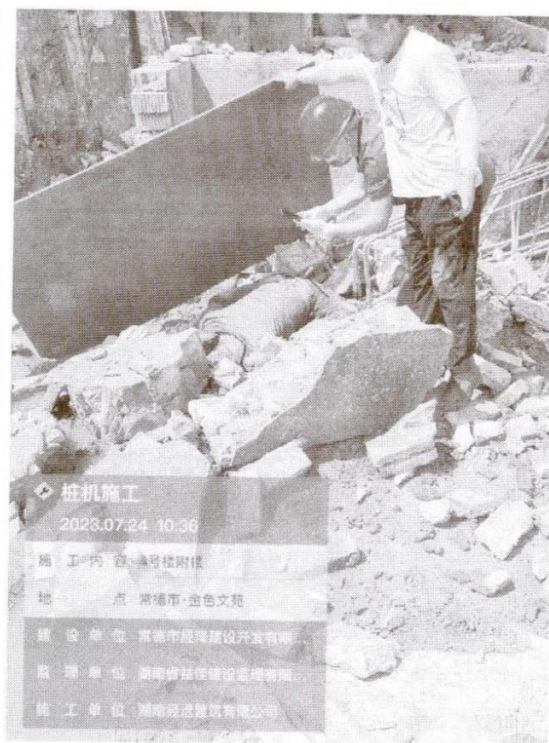
图 7 事故现场照片
