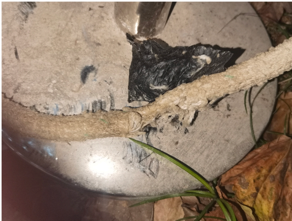
图2胶带捆扎部位吊绳存在明显的断股破损
