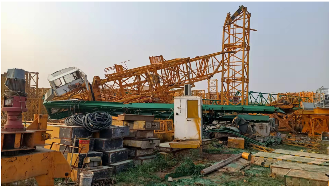
图2 事故现场断裂的标准节立柱
