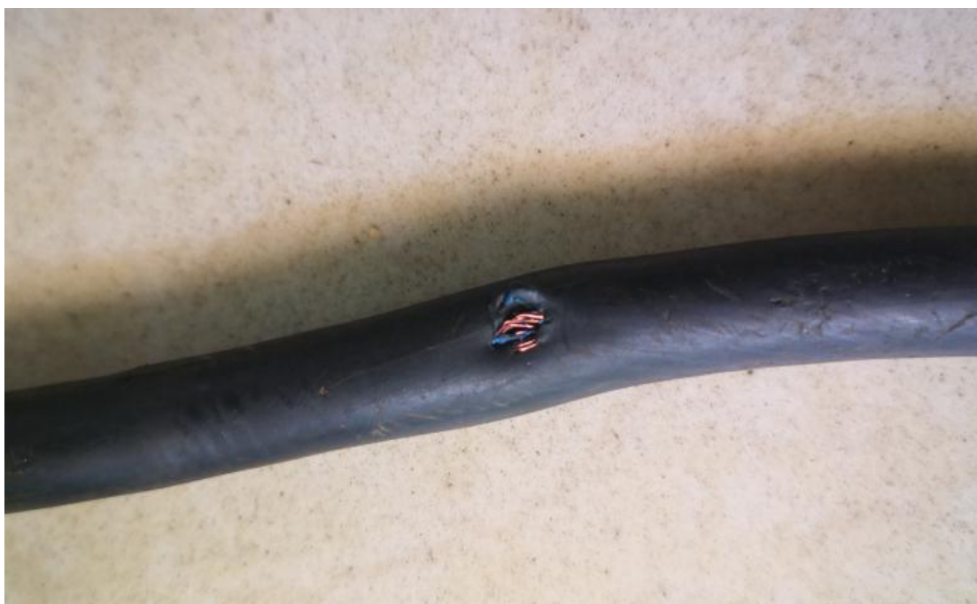
图 4：大潜水泵（外观为绿色）的电源线破口处铜线裸露明显可见
