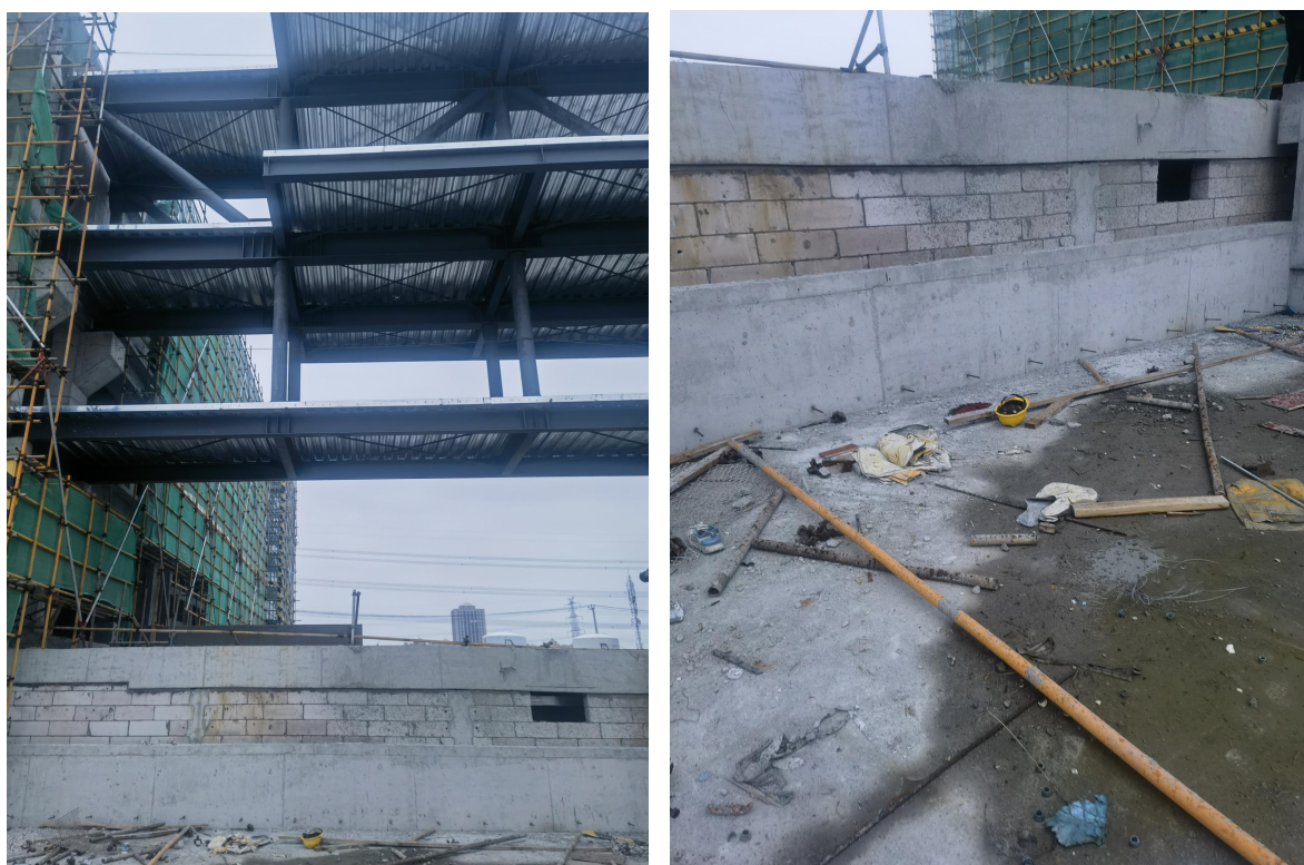
图 1、2 事故现场照片
