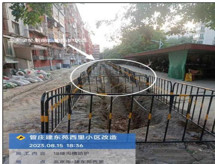
图 3 金某录坠落前沟槽临边防护状态
