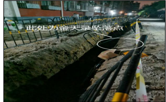
图 2 金某录坠落位置
