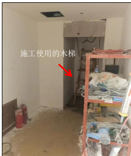
图 1 事发储物间内
