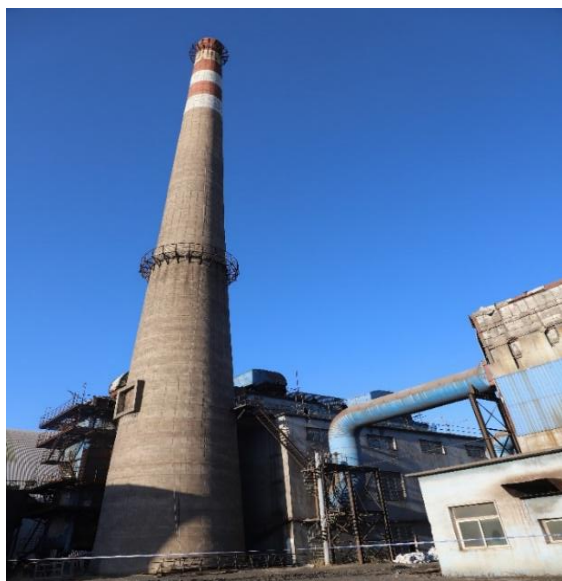
事故现场立面全景图
