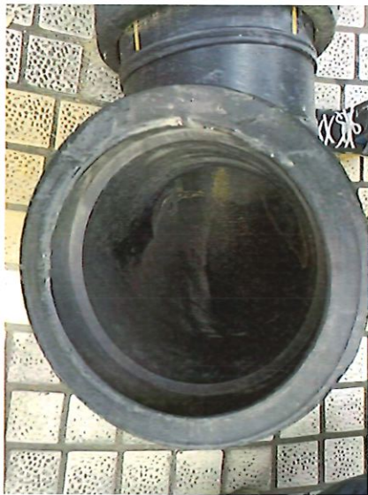
图 5a 泄漏处弯头 1 端面状态
