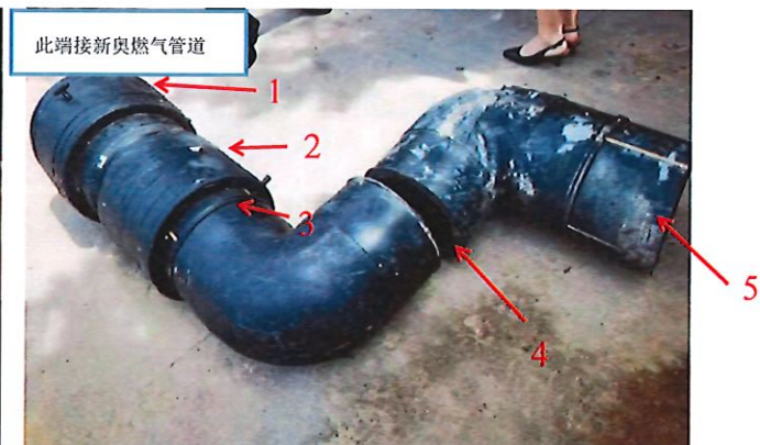
图 4b 切除的泄漏管段焊口位置图
