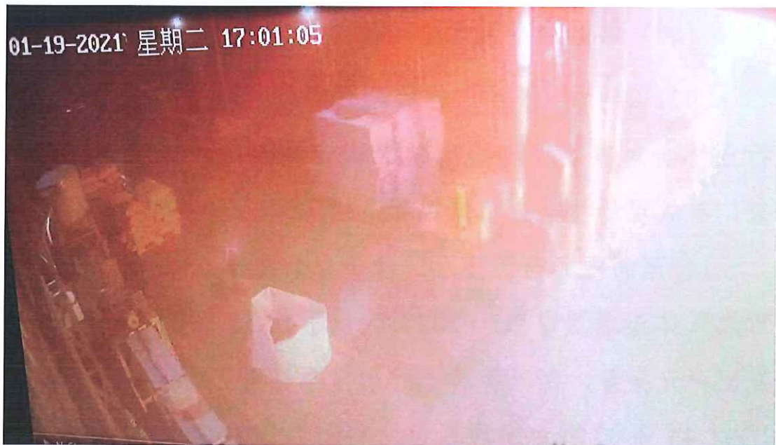
图 9、立式配电柜处被引爆
