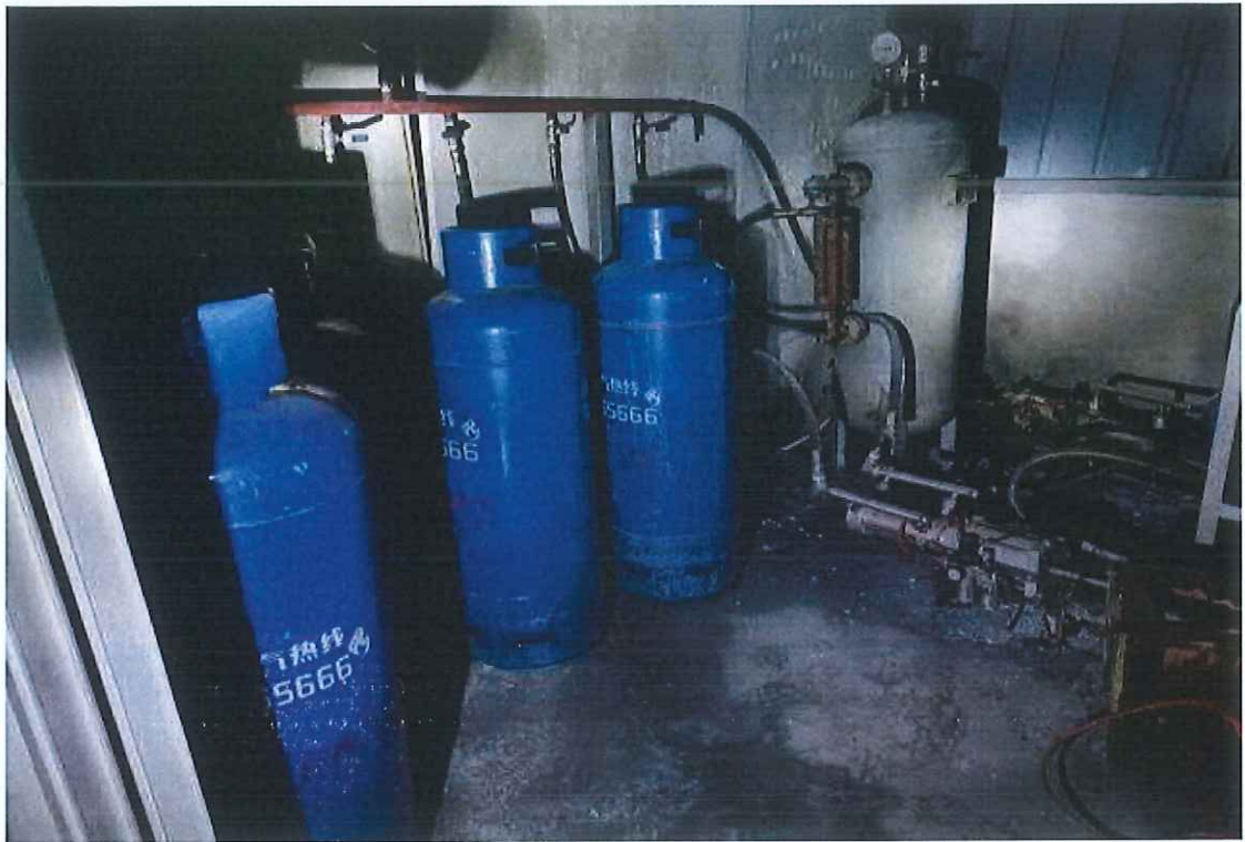
图 2、液化石油气供气房（泄漏点）
