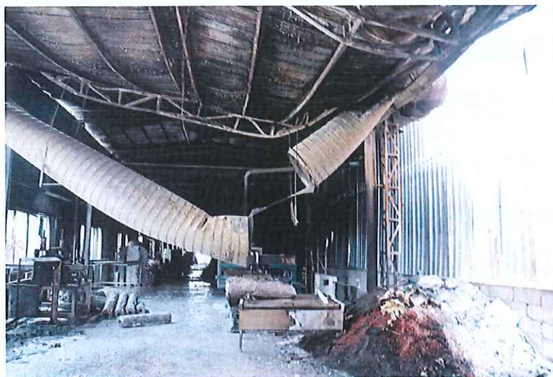
图 10、回收车间部分屋顶被烧塌
