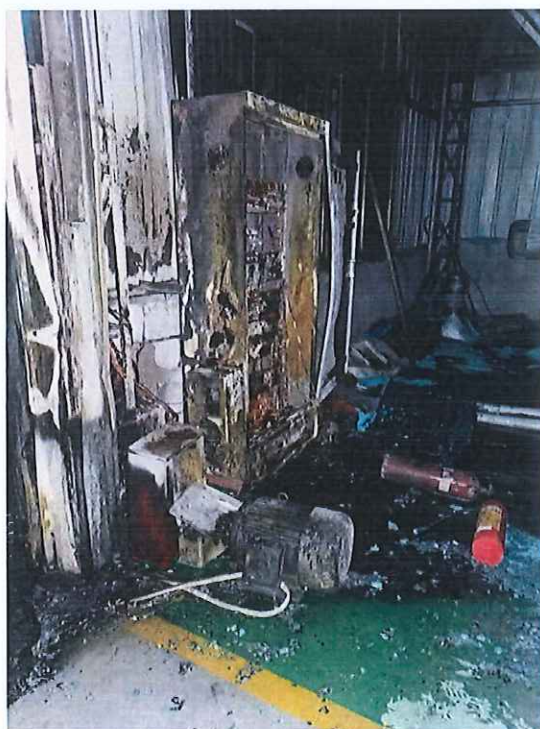
图 3、立式配电柜（引爆点）
