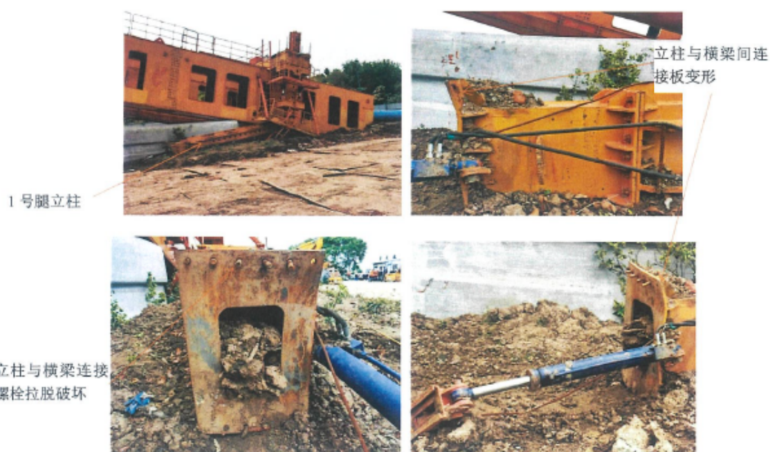
架桥机 1 号支腿东侧立柱与支撑横梁栓接处变形
