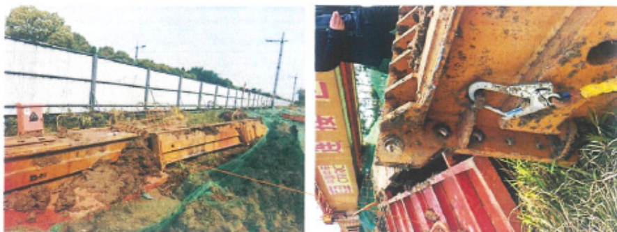
1号支腿支撑横梁已断开（但连接法兰盘完好）
