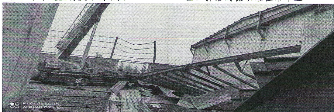
图8 掉落的6号棚顶呈180度翻转及汪某海、杨某武坠落地点
