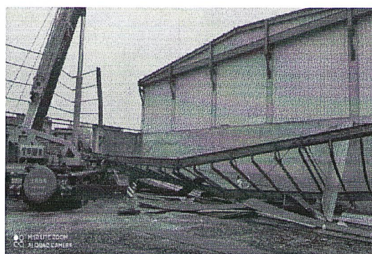
图7 掉落的棚顶砸在吊车上
