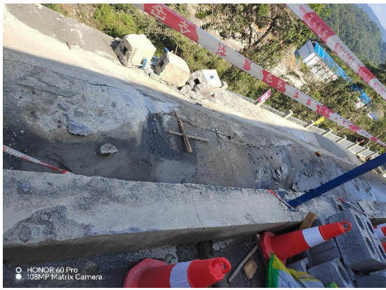
图4 "9·13"事故1号混凝土填料车间通道外堡坎图片
