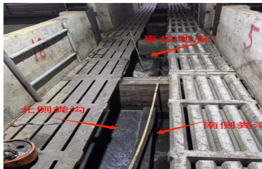
图 7 事故地点水管及排污口塞子
