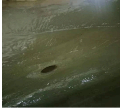
图6 从超纯净水箱里面拍照发现进水管未安装进入箱体内部
