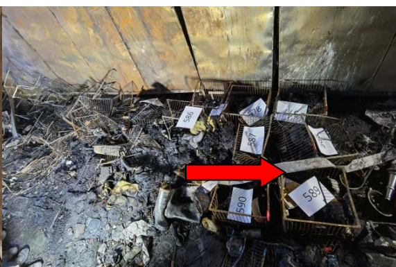
0625 号吊篮南侧烧损情况
