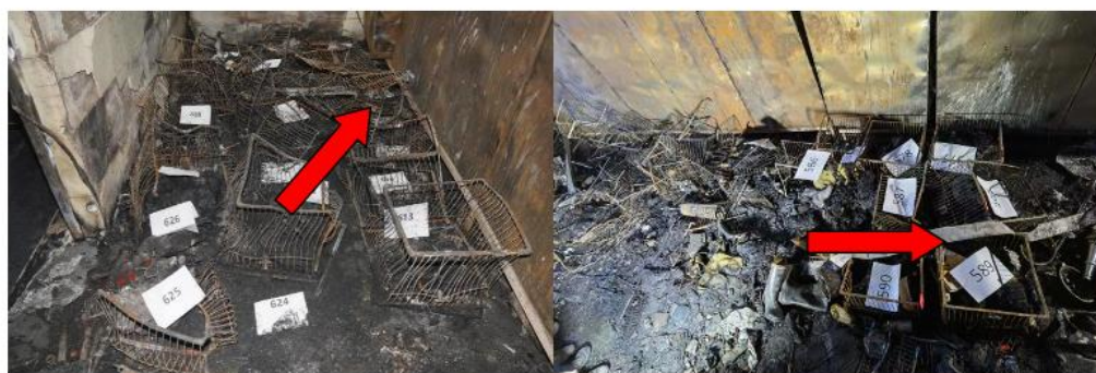
0625 号吊篮附近烧损情况
