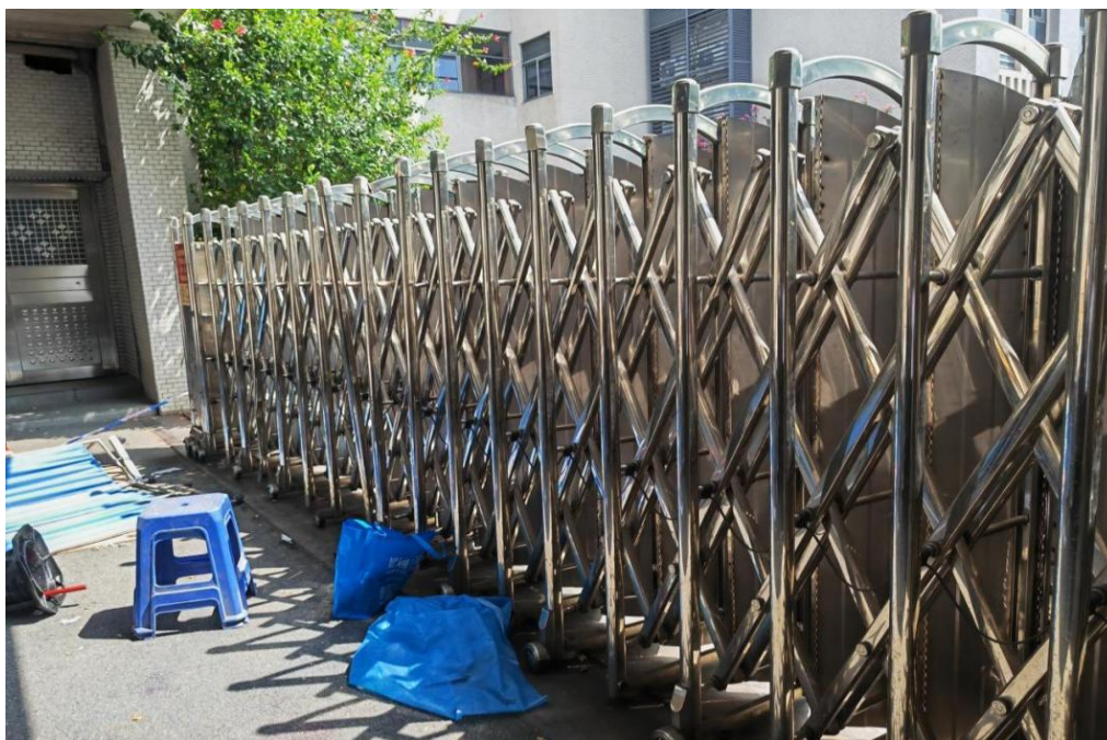
图-7 7号门的电动伸缩门整体情况
