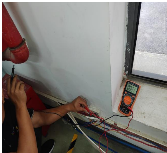
图-20 装备车间固定插座接地检测
