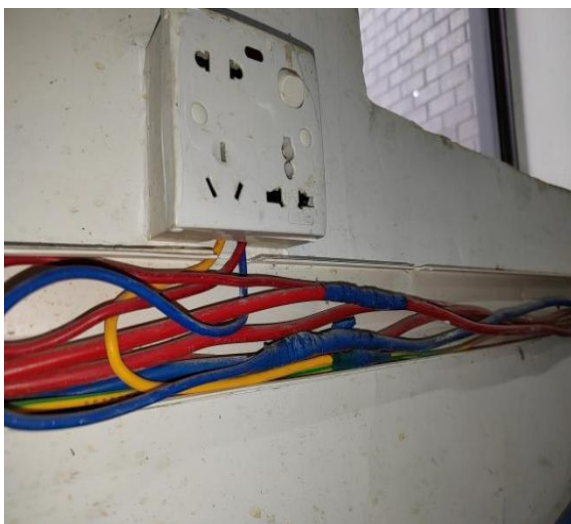
图-19 装备车间固定插座情况
