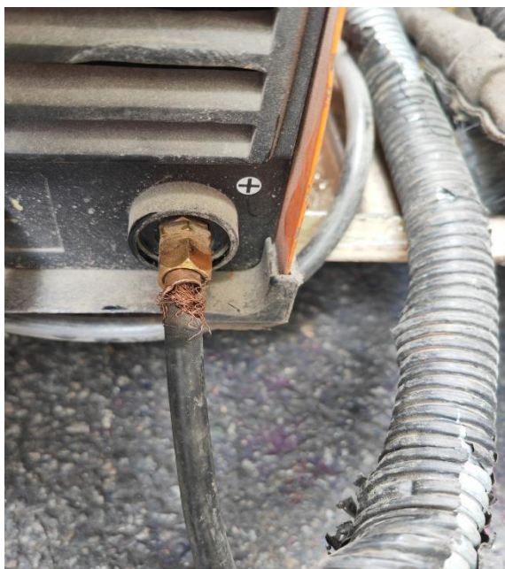
图-16 氩弧焊机正极进线处破损
