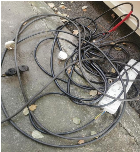
图-5 事故现场使用的电源线路
