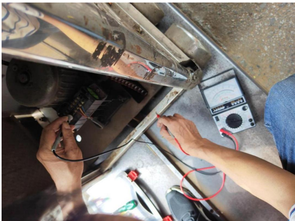
图-10 现场测定电动伸缩门没有漏电
