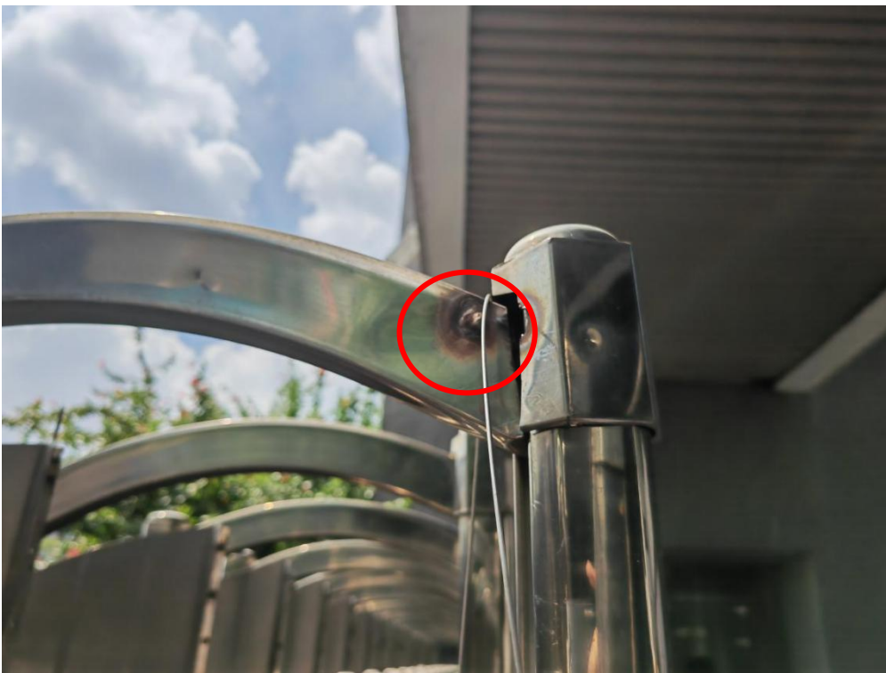
图-9 电动伸缩门焊接痕迹和焊条
