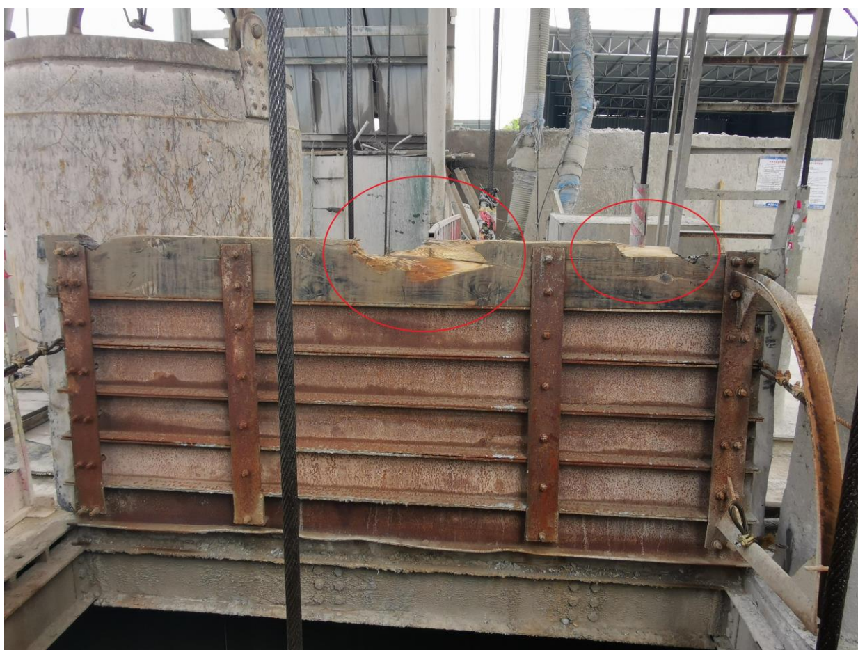
（图 12 北侧井盖门两处开裂缺损痕迹）
