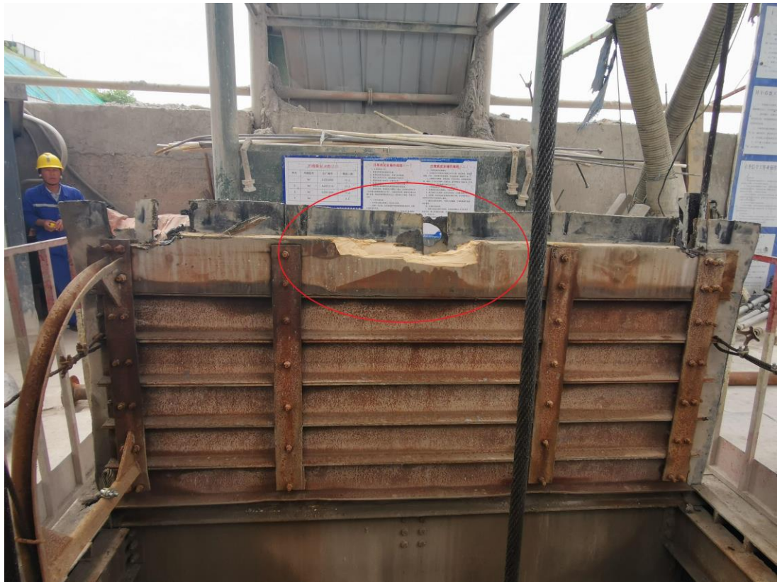
(图 13 南侧井盖门一处开裂缺损痕迹)
