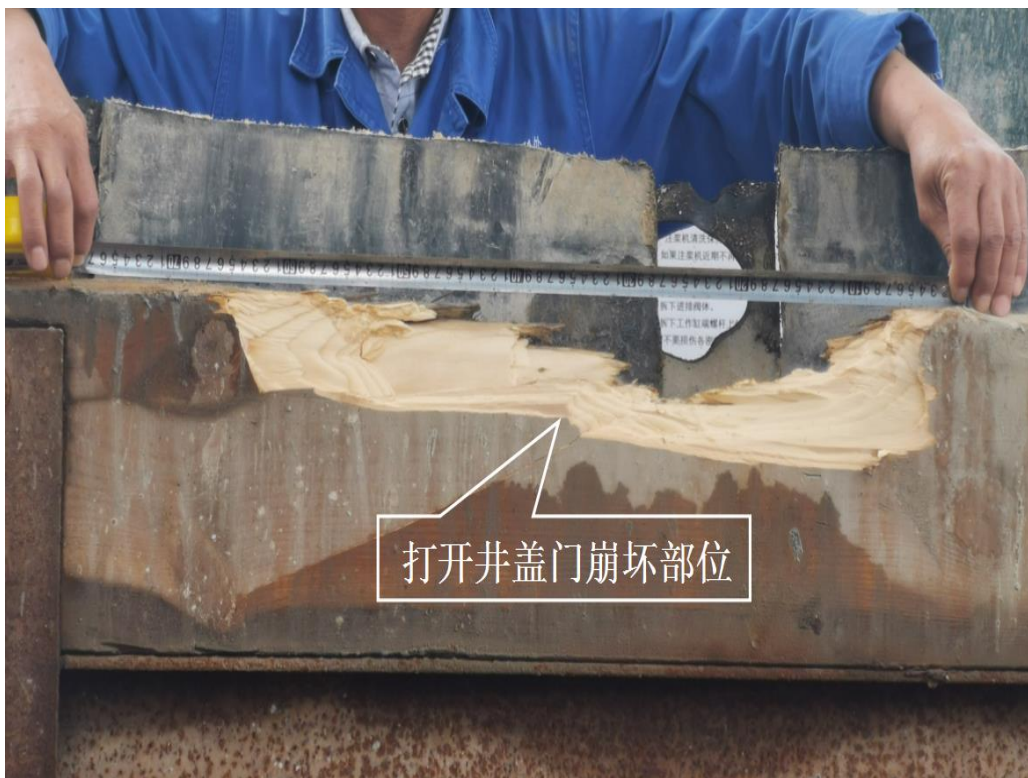
(图 14 南侧井盖门一处开裂缺损痕迹)
