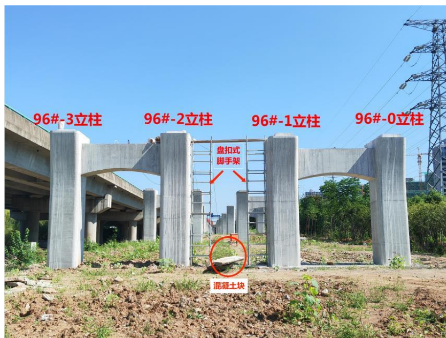
图 1：事故现场概貌
