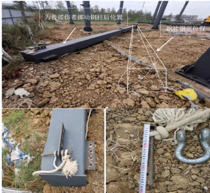
图 4. 事故弓形卸扣、自制的钢筋销轴及吊装物
