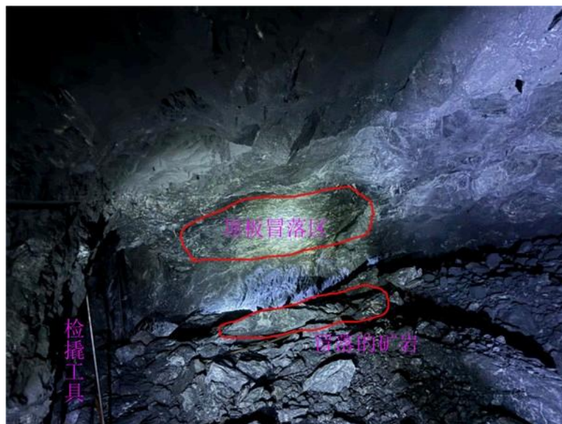
图“5.26”冒顶事故发生地点照片
