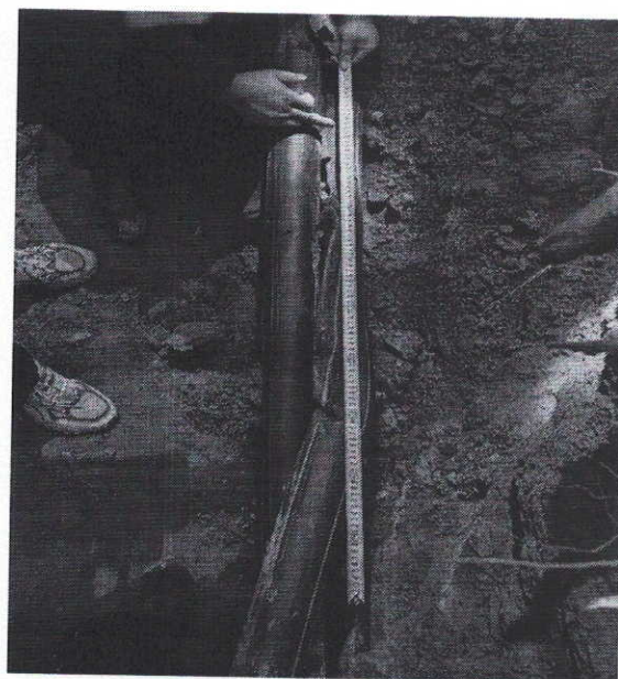
图二 管道破损图
