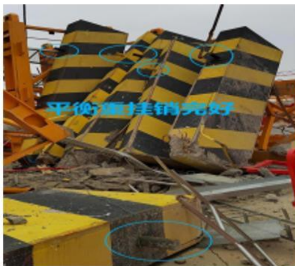
事故塔机坠落的平衡重及挂销情况
