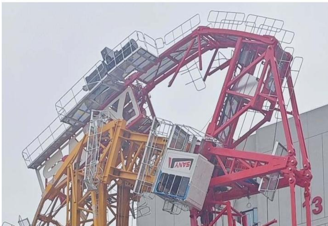
事故塔机结构坍塌局部（顶部）图
