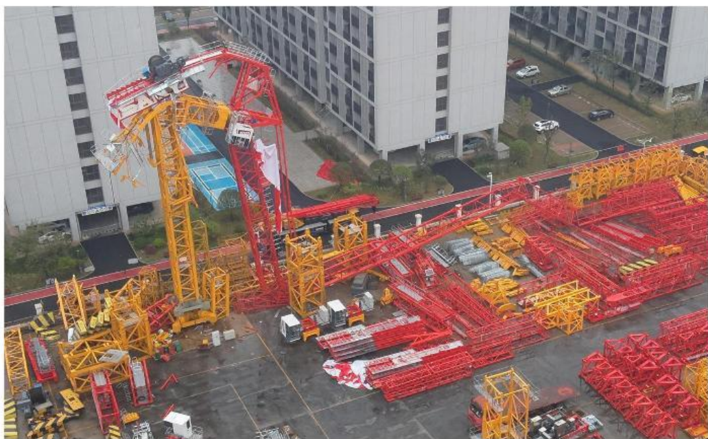
事故塔机结构坍塌整体外貌图
