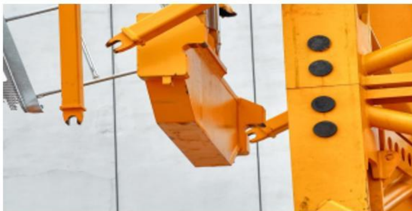
事故塔机爬升架损坏整体情况
