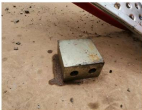
事故塔机坠落爬爪（西北向）的支撑块
