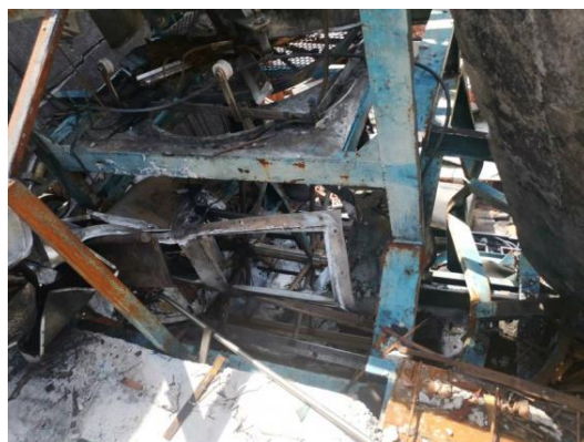
图 12 机械设备受损后的照片
