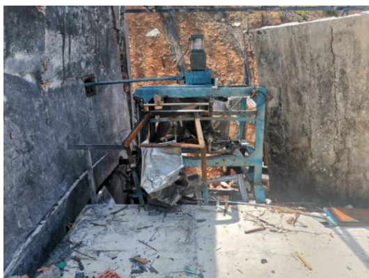
图 9 工房受损后的照片（二）
