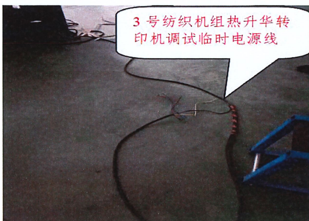
图 4 涉事转印机临时电源线
