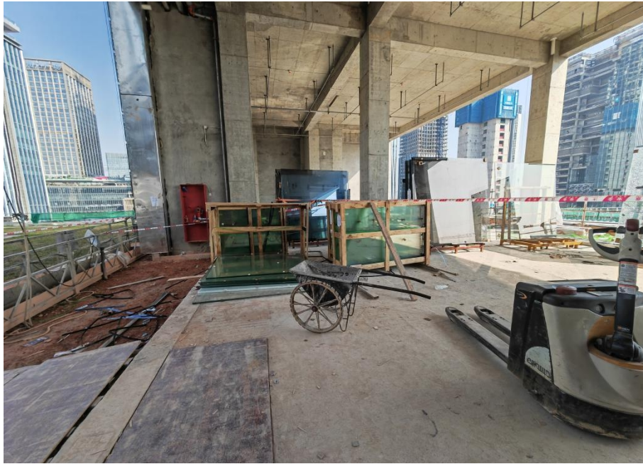
图 4 事发现场玻璃存放情况 1
