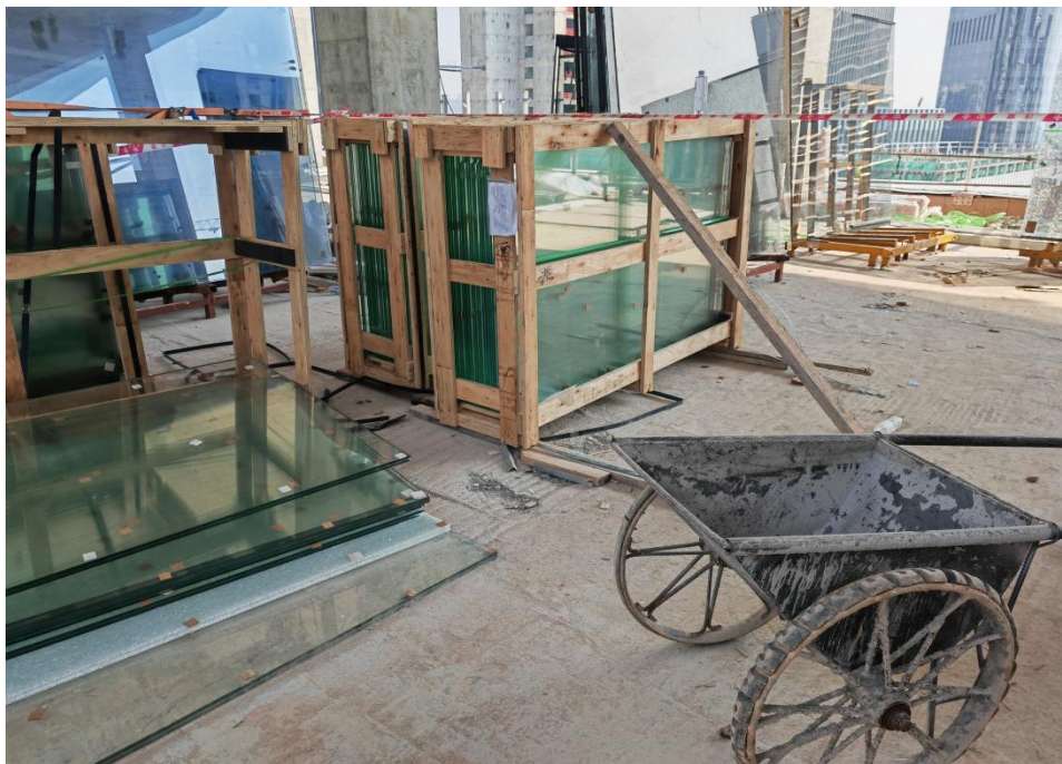
图 5 事发现场玻璃存放情况 2
