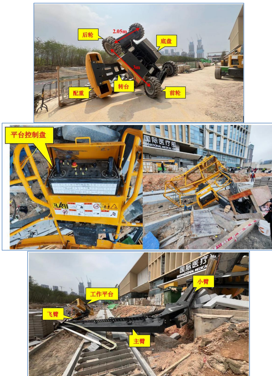
图 11 涉事高空作业平台倾覆情况
