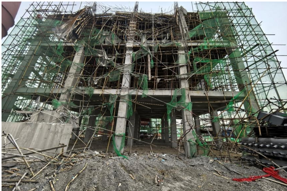
图 2 收尘框架坍塌后现场图
