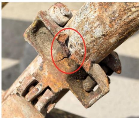
图 9 扣件陈旧裂纹
