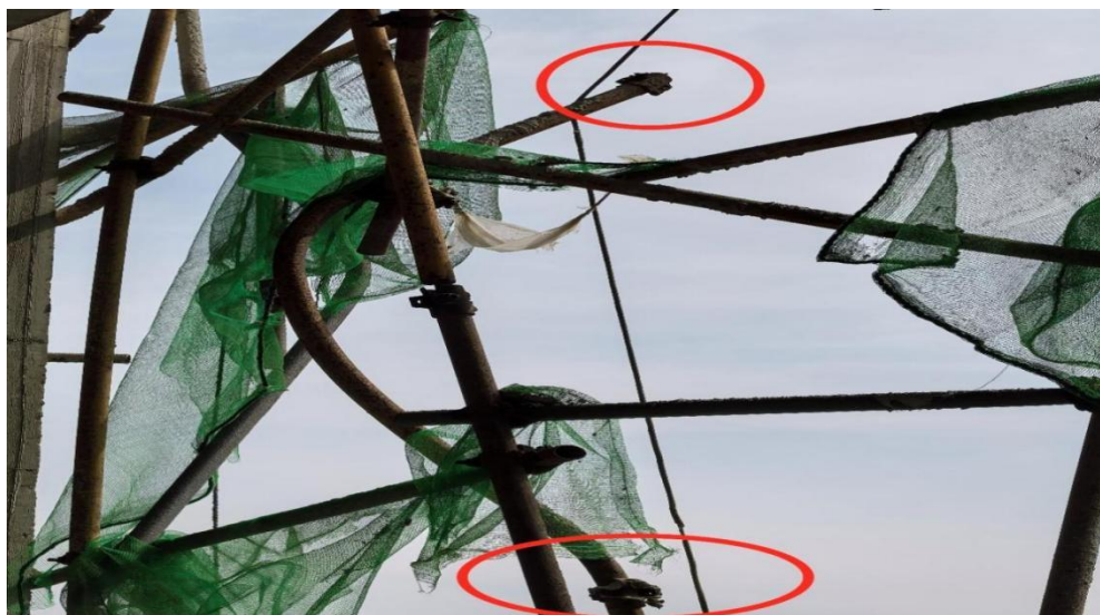
图 6 立杆弯曲变形扣件断裂
