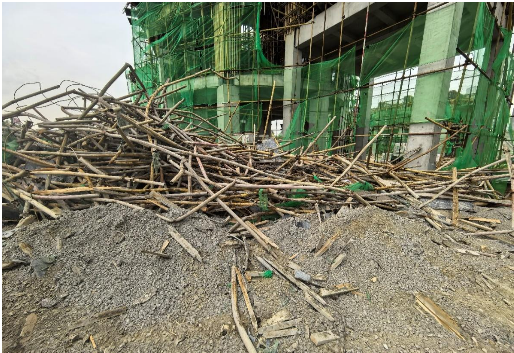
图 5 东侧坍塌材料堆积处
