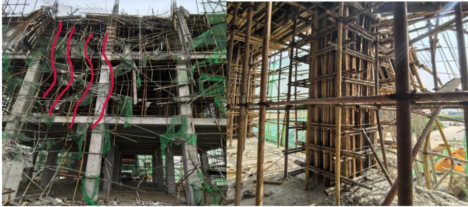
图 11 脚手架弯曲变形 图 12 三层无连墙件杆件
