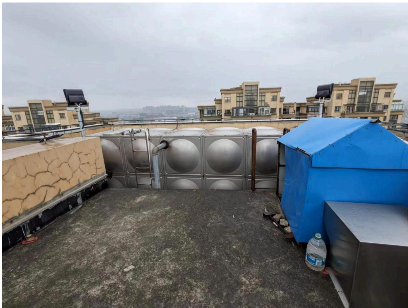
图3 不锈钢水箱与放有水泵的蓝色铁皮屋
