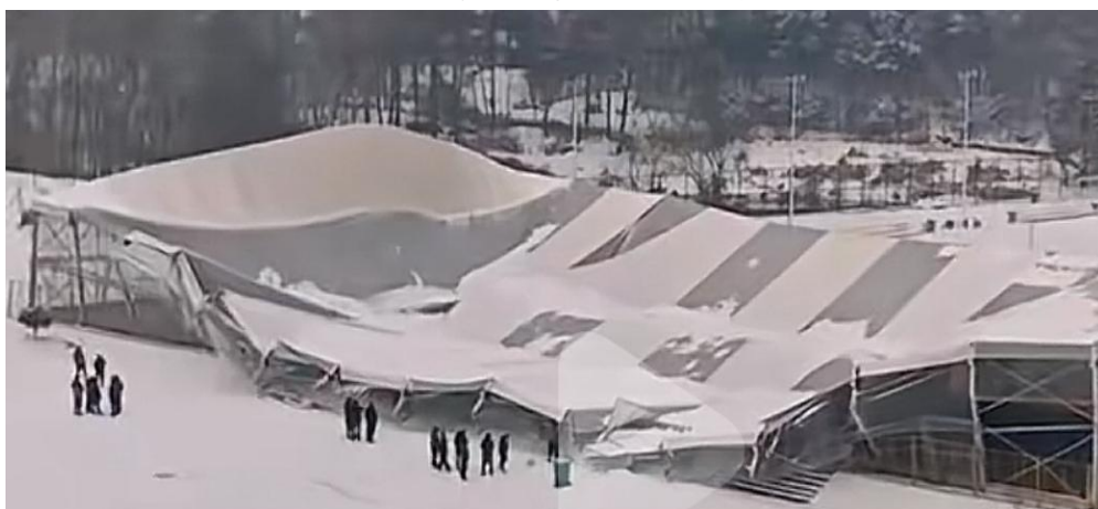
图 2 篮球场篷房坍塌现场图
