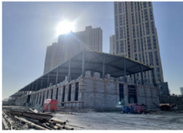
图 1 事故现场概貌 (1)
