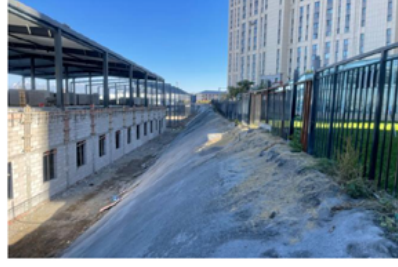
图 2 事故现场概貌 (2)
