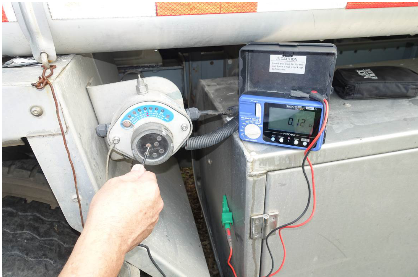
图5.检测溢油静电传感器的接地触点与事故油罐车的总接地端子之间的电阻
