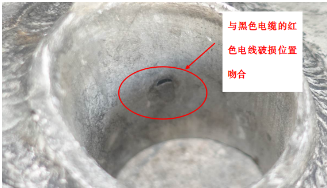
图10.穿线管靠上断口的内部有一处焦黑（红圈处）
