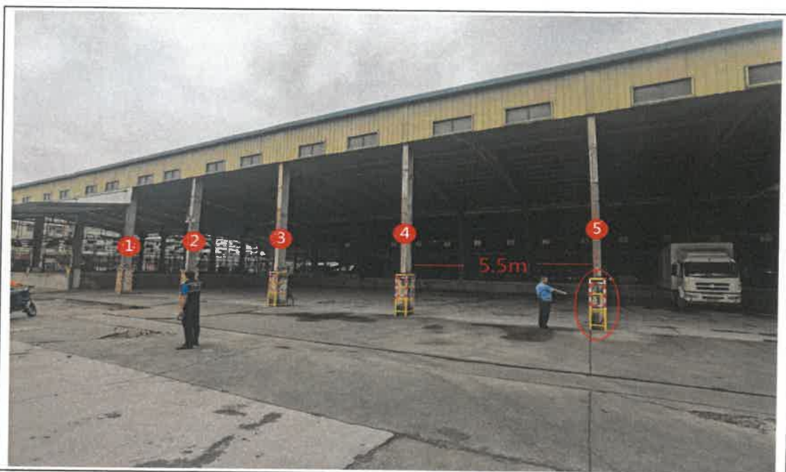
图 1 事故现场情况
