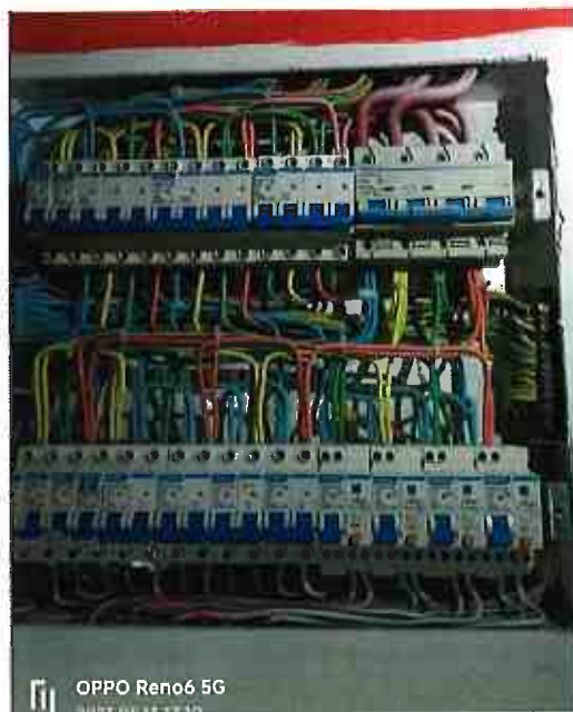
图 8 一楼电源开关箱
