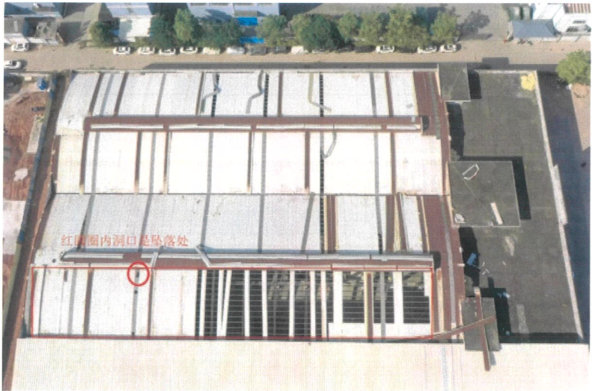
图2 涉事屋面作业面（高处坠落处航拍图）
