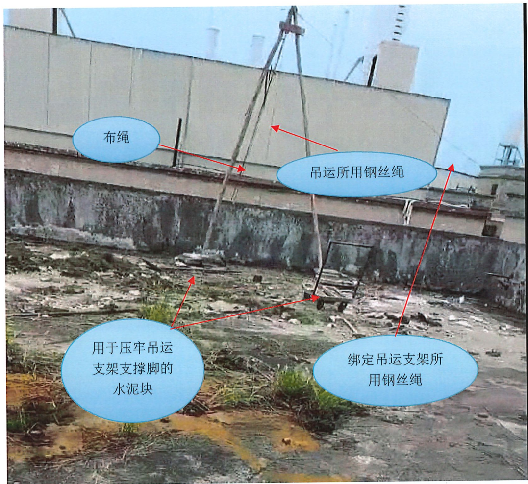
图 9 事发前吊运支架搭设情况图
