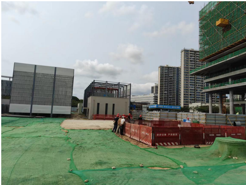
三亚崖州湾南繁科技城区域集中供冷项目 1 号能源站外景图
