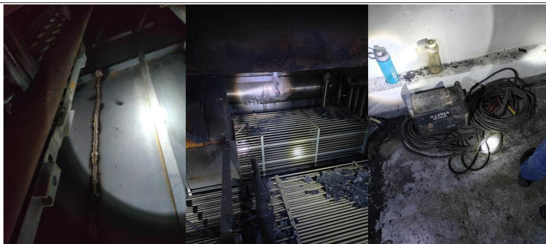
图 3.3 事发后蓄冰池内部情况 - 侧壁与焊机
